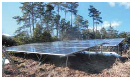
白州発電所 1 号機 9.9kW
